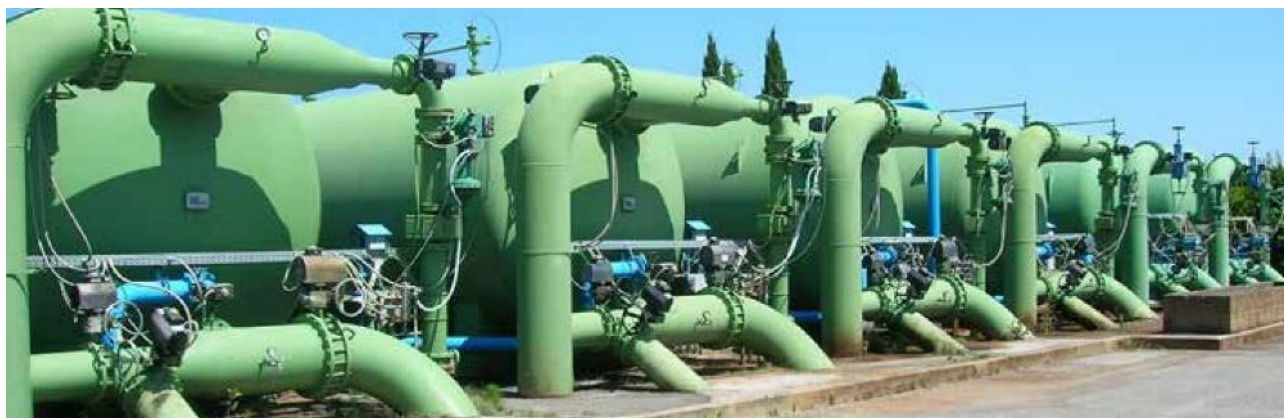
Impianto di potabilizzazione di Mortaiolo, Collesalveti.
